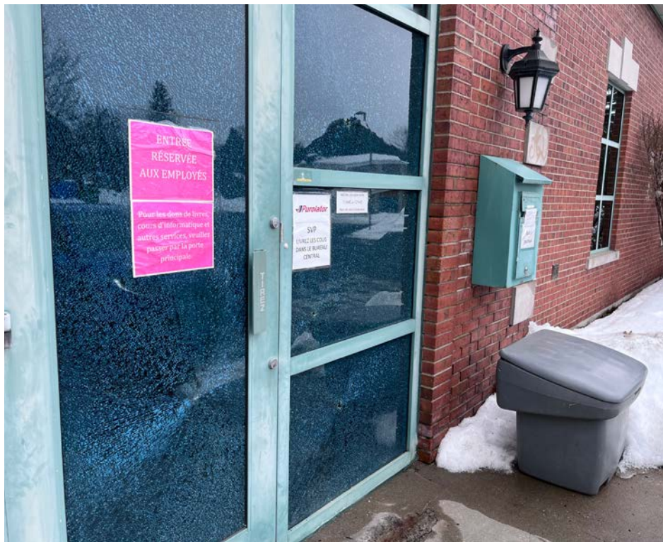
Les vitrines de l'entrée de la bibliothèque réservée aux employés ont été endommagées. (Photo : Frank Jr Rodi)
