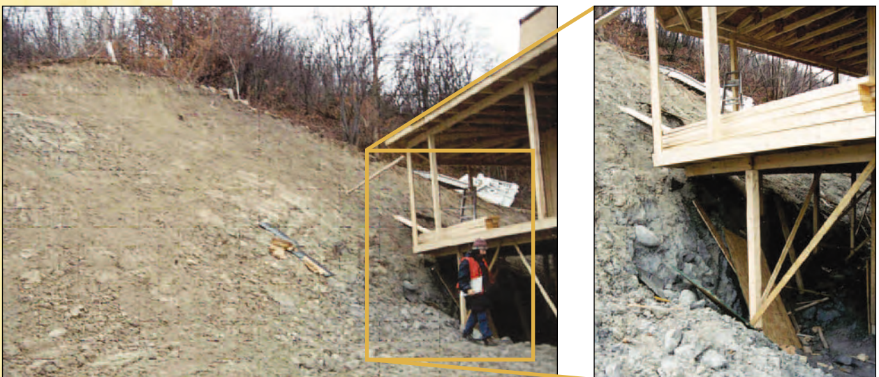
Figure 14 : Déblai à la base du talus
