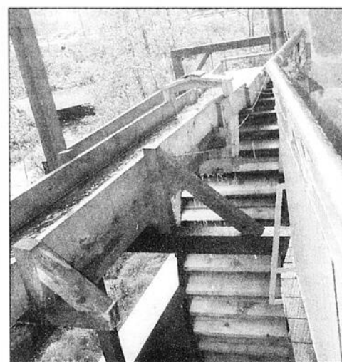
La dalle qui amène l'eau à la roue à godets.
