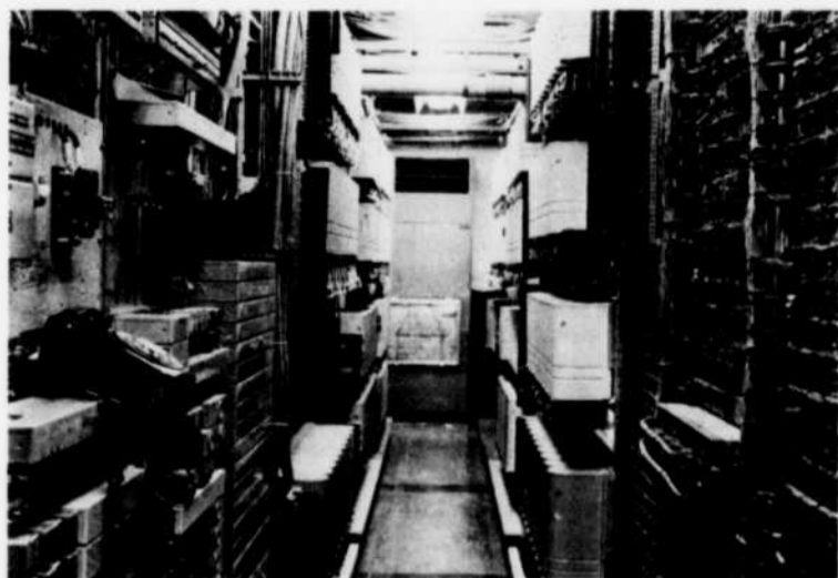
La salle d'équipement de la compagnie Bell, située au rez-de-chaussée du bureau principal des Usines de Jonquière, contient une quantité impressionnante de fils, tableaux, câbles et circuits. Un véritable casse-tête pour qui ne s'y connaît pas. (Photo Jean Matteau)
