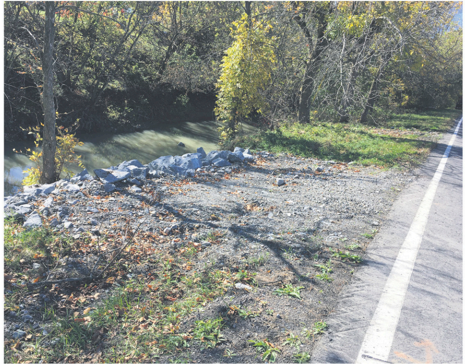
Dans la cour arrière de Pierre Gilbert, on constate les dommages laissés par l'eau: sur l'autre rive du ruisseau, il est possible de voir que le cours d'eau se rapproche de la route avec les années et que des travaux de stabilisation seront nécessaires, de l'avis du résident.
