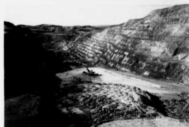
Pit Luce, Labrador City. Une vue sur toute la longueur de la fosse.
