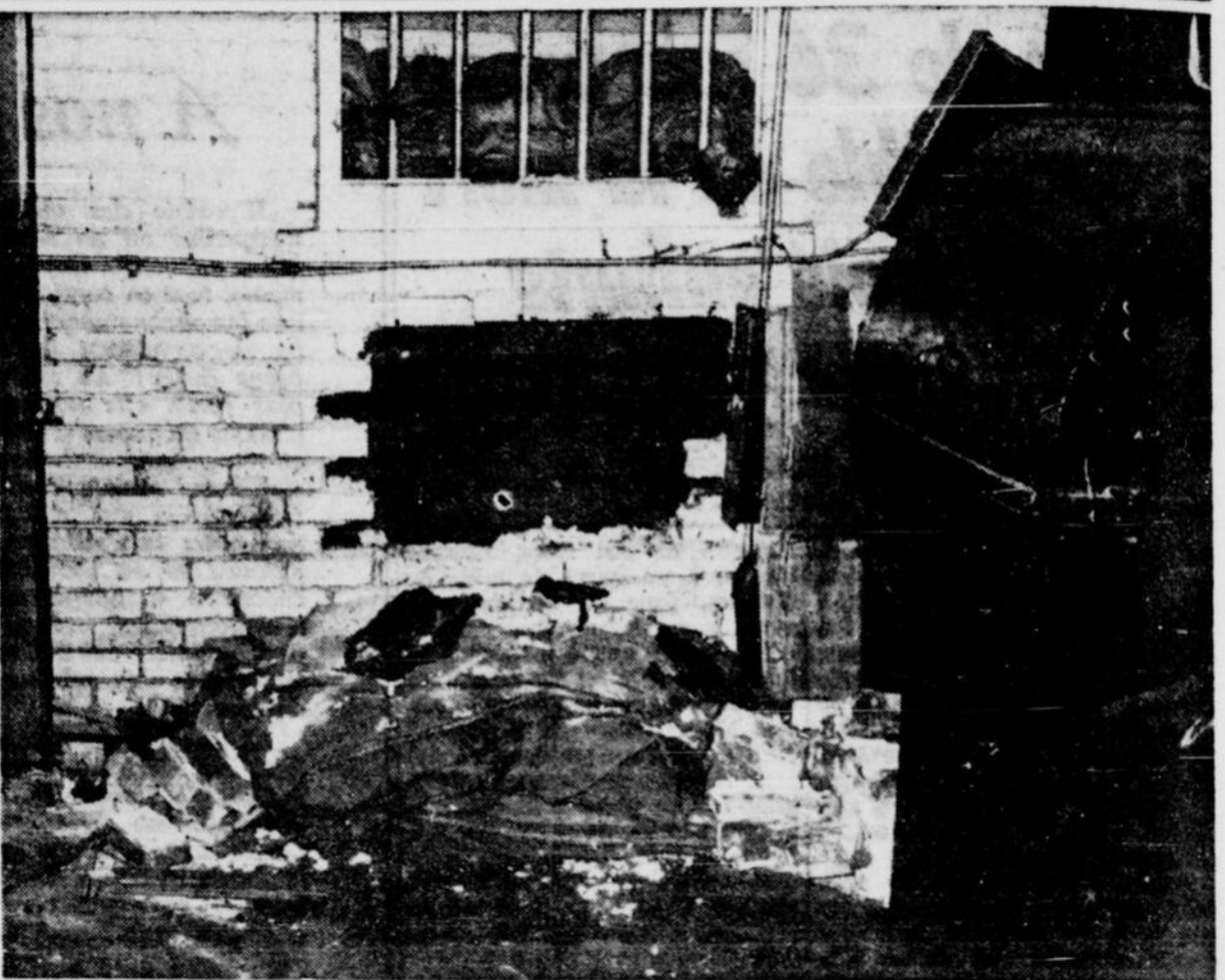
DES VOLEURS, qui ont vainement tenté, hier, de fracturer un coffre-fort en se servant de nitroglycérine, ont pénétré dans les bureaux de la maison Brossard et Charret Ltd., 6370, boulevard Saint-Laurent, en pratiquant un trou à travers un mur arrière de l'édifice.
