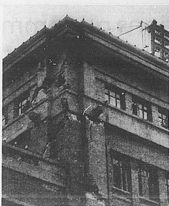
Les immeubles lézardés comme celui-ci — Bai Hua Da Lou, le plus grand magasin de Pékin — sont légion dans la capitale chinoise, où le terrible tremblement de terre de mercredi a causé des dégâts considérables. Les Pékinois ont été avisés de quitter leurs demeures, certains signes faisant craindre de nouvelles secousses telluriques, et la popu-
