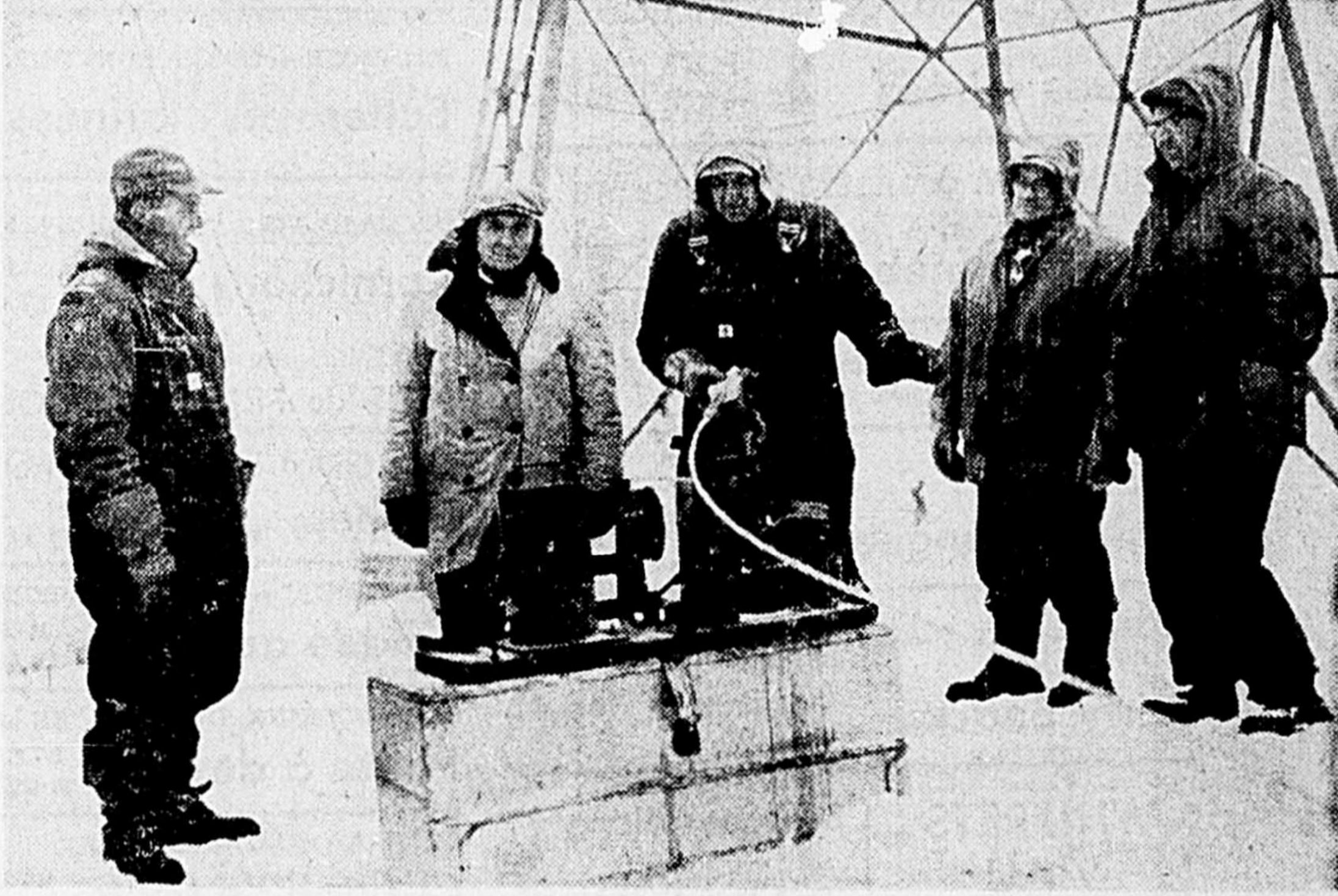
SAGUENAY POWER A COMMENCE, HIER MATIN, l'installation d'un nouveau circuit qui reliera la ville de Chicoutimi-Nord à Saguenay-Power. Cette localité recevra son courant électrique directement de Saguenay Power. Deux tours ont été érigées sur les rives du Saguenay pour relier le courant à Chicoutimi-Nord. Cette photo nous fait voir une équipe d'hommes en train de compresser le fil d'açier conducteur qui sera attaché aux tours. Ce sont, de gauche à droite, MM. Georges Roy, Henri Fortin, Jos. Marcoux, Auguste Bluteau, contremaître général, et Camil Gagnon, tous de Saguenay Power. (Photo "Le Progrès" par BLM)
