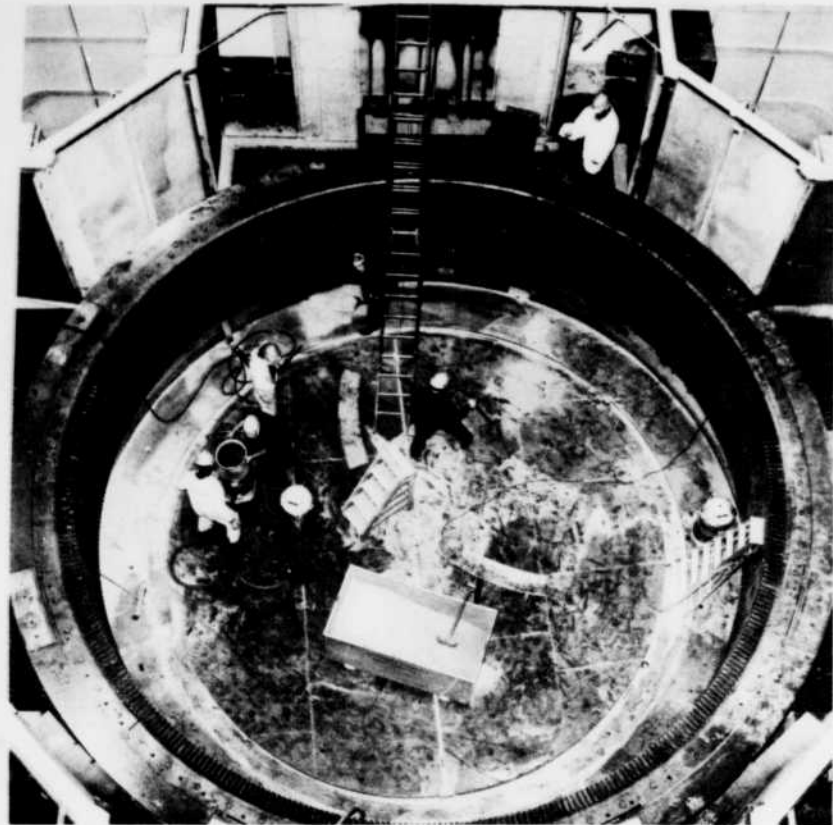
Du haut de la cabine du pont-roulant, l'intérieur du stator de l'alternateur numéro 2 de Shipshaw fait un peu penser au stade olympique, sans son toit de toile. Les 432 bobines ont été enlevées, les encoches faites de métal laminé ont été nettoyées avec des granules de blé-d'Inde lancées sous pression, c'est d'ailleurs ce qu'on nettoie présentement avec les aspirateurs. Maintenant, on mettra les bobines neuves en place, les raccords à la couronne, le rotor et l'arbre de commande, le support en araignée, excitatrice, moteur de régulateur, panneaux de fermeture. Et la numéro 2 pourra être remise en production. En haut à droite, sur le stator, M. Honoré Petitpas, un fils des Iles, aujourd'hui saguenéen et citoyen de Jonquière, chef d'équipe, électricité, affecté à ce radoub.
