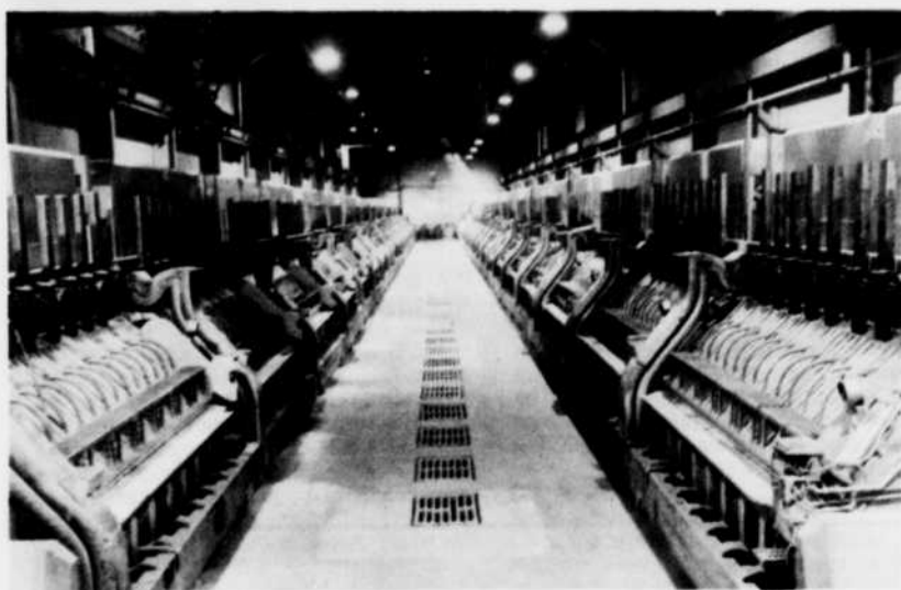
La nouvelle salle de cuves à anodes précuites aura une production envisagée de 25,000 tonnes d'aluminium par an. Ici, on peut voir la section nord de la bâtisse B.
