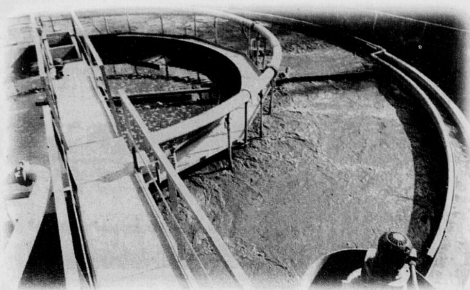
À la station d'épuration d'Ayer's Cliff, traitement par boues activées.
