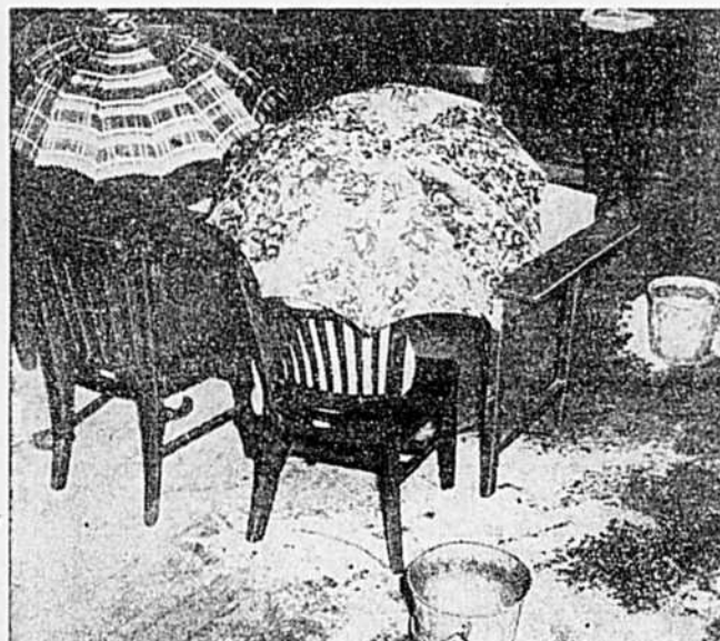
AVERSES D'AVRIL — Des employés du service du revenu, dans les bureaux situés au second étage du Palais de justice de Chicago, doivent travailler à l'abri de leur parapluie en attendant qu'on répare le toit. Il y a même des seaux pour recueillir les gouttes d'eau qui tombent du toit.
