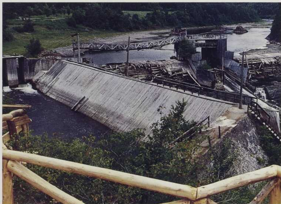
À Rimouski, on songe à restaurer ce vieux barrage en ruines. Un des scénarios envisagés pourrait submerger un parc pédestre.
