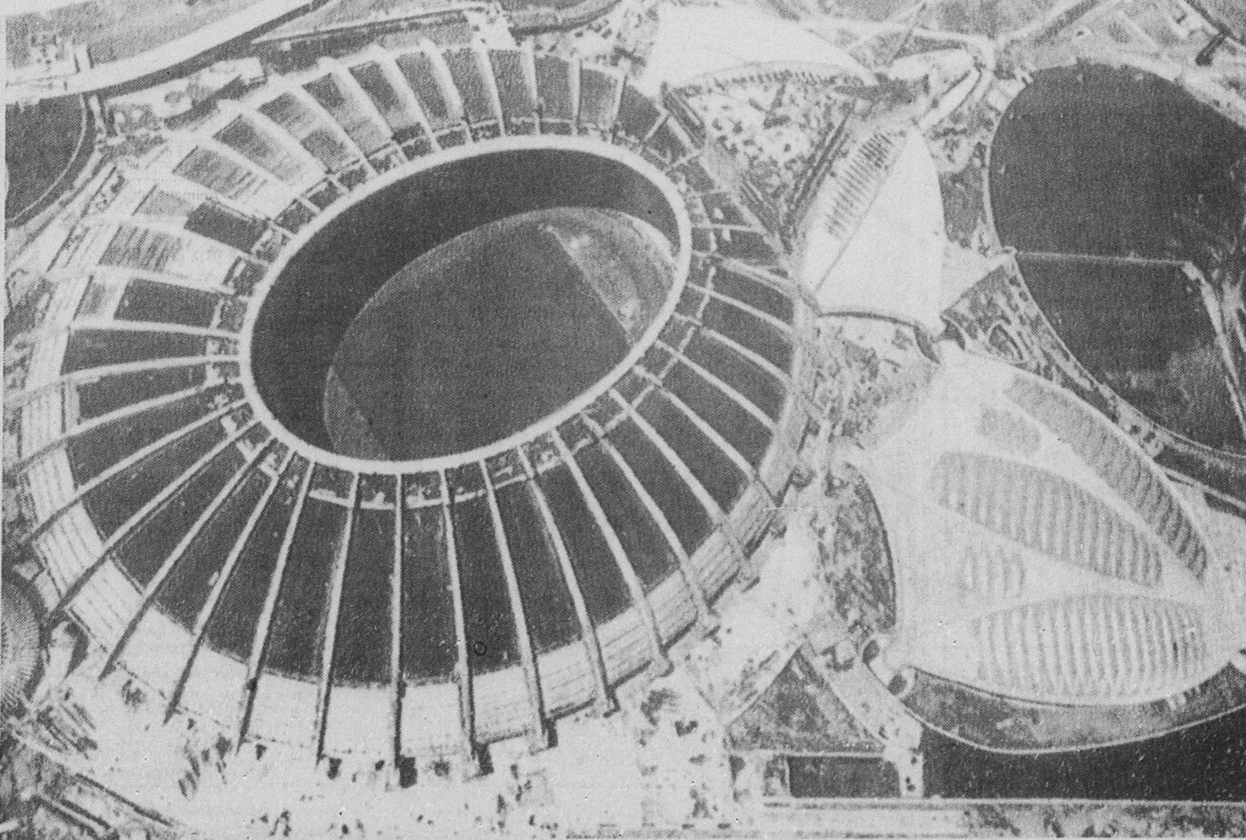
Le stade olympique et le vélodrome, tels qu'ils étaient avant-hier. Les travaux doivent être complétés le 14 juin.
