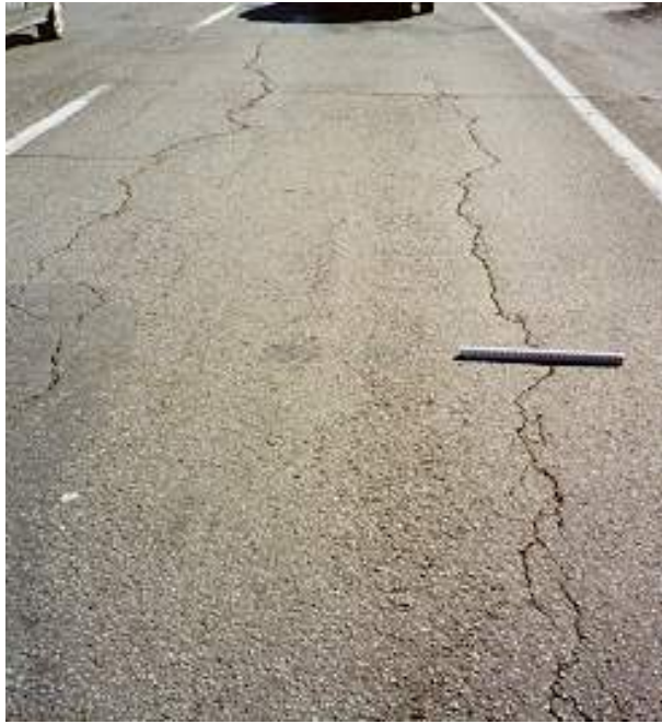
Photo 3.7.1 c) Fissure longitudinale (en piste de roue)
