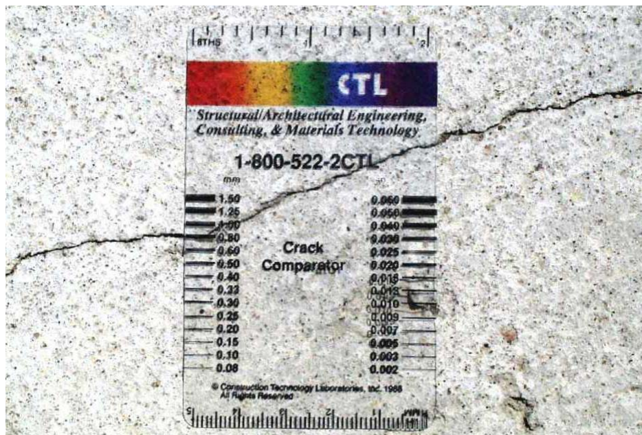
Photo 3.2.7 i) – Fissure moyenne, largeur de 0,7 à 1,375 mm
