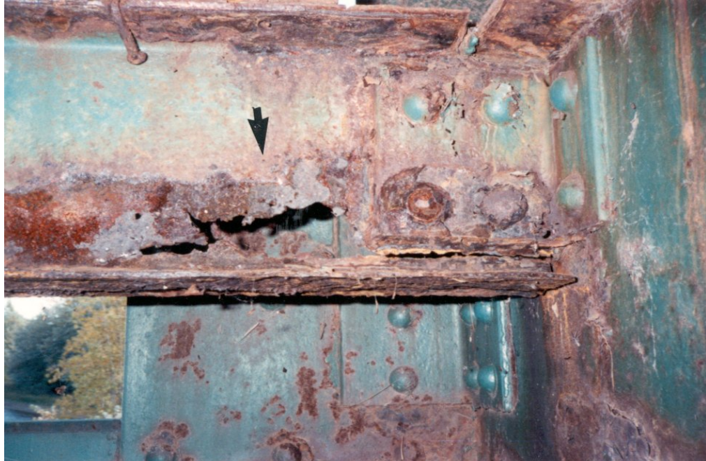
Photo 3.3.1 d) – Corrosion très importante d'un longeron
