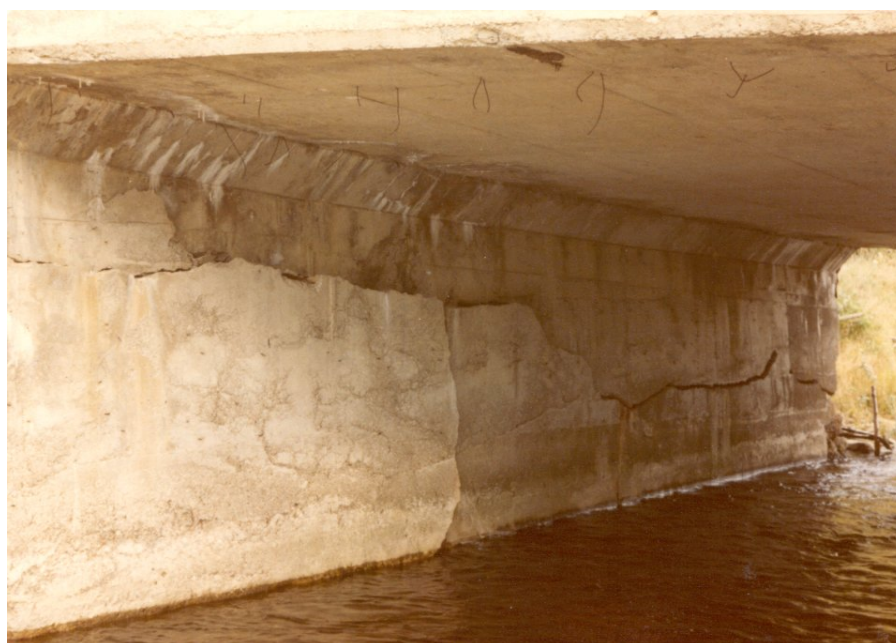
Photo 3.2.7 e) – Fissures causées par des tassements différentiels
