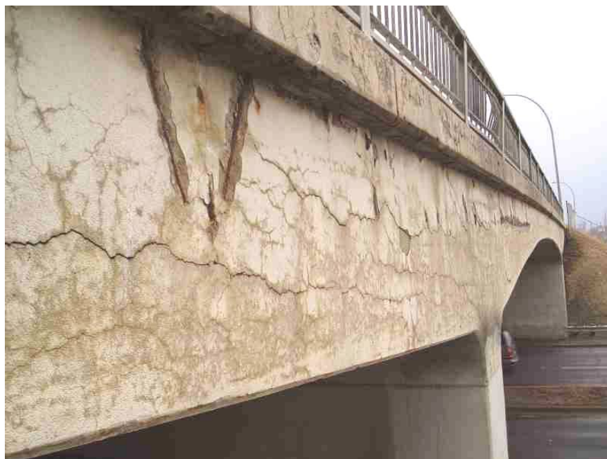
Photo 3.2.7 d) – Fissures causées par la réaction alcali-granulat
