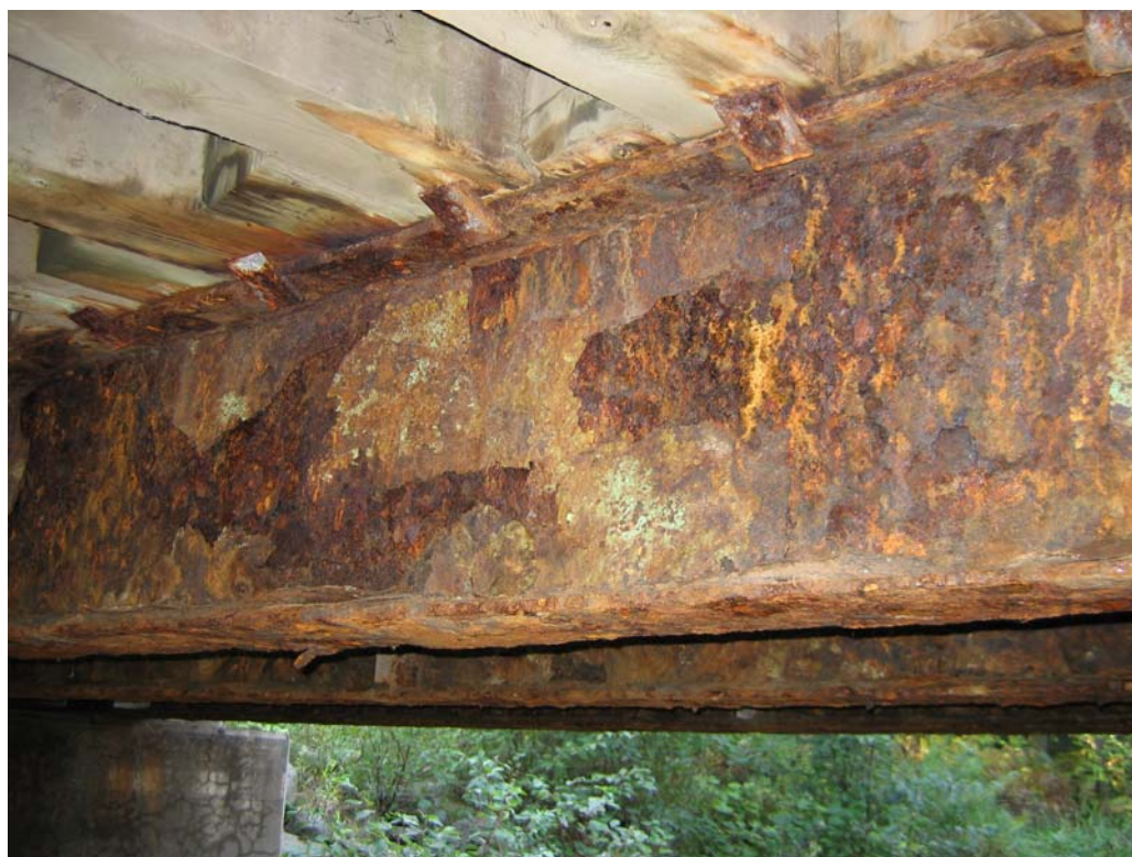
Photo 3.3.1 c) – Corrosion importante d'une poutre
