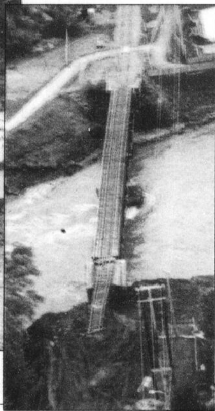
◀ LA VOIE ferrée qui enjambe la rivière-aux-Sables près de Place Nikitoutagan à Jonquière est dans un piteux état.
