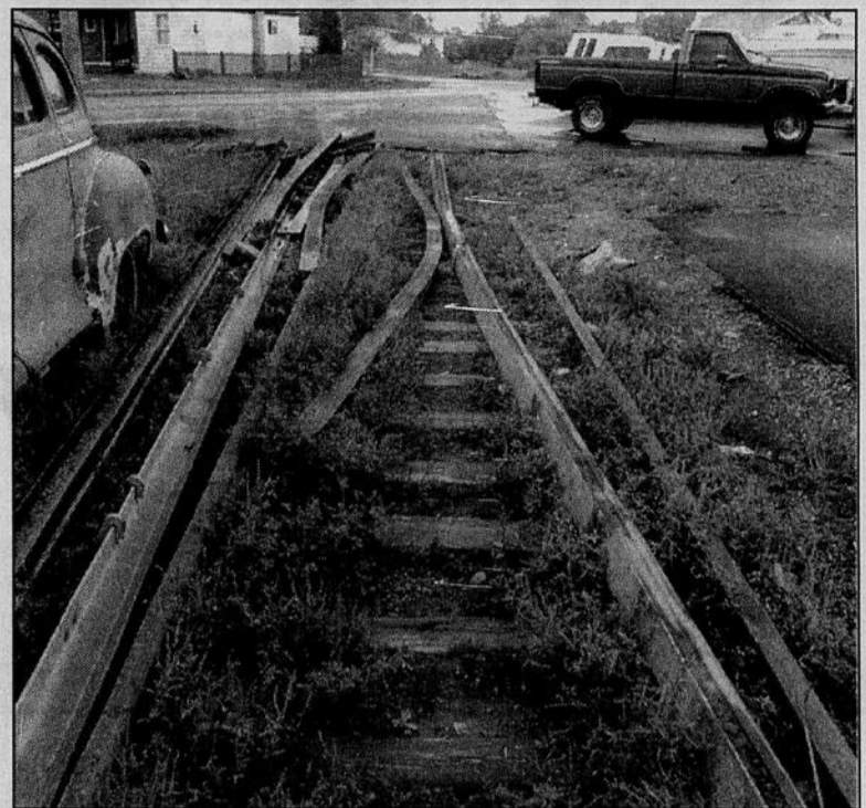
La voie ferrée était en piteux état depuis plusieurs années. ARCHIVES
