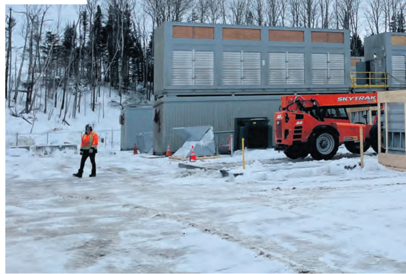
Le centre de données des Escoumins commencera ses opérations à la fin février et c
