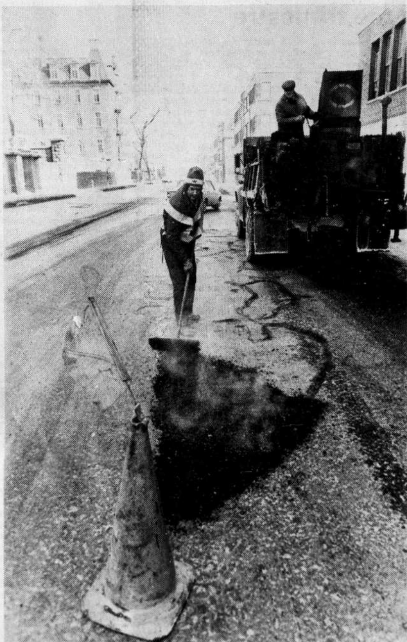
L'alternance du dégel et du gel provoque la formation de trous dans la chaussée, causant beaucoup d'ennuis aux automobilistes. Ici, une équipe de la ville de Montréal procède à un recouvrement temporaire d'asphalte, en attendant de pouvoir faire, le printemps venu, une réparation permanente du pavage.
