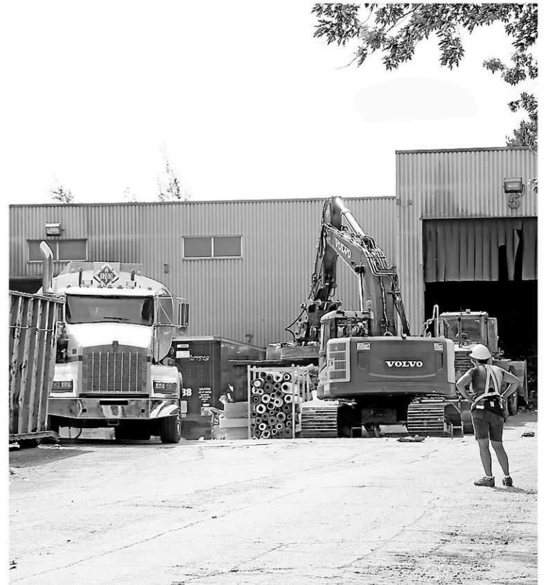
Une excavatrice a reculé sur le pied d'un employé, lundi matin, dans la cour de Sani-Éco, à Granby. Son pied a été broyé par le poids de la machinerie. — PHOTO CHRISTOPHE BOISSEAU-DION
