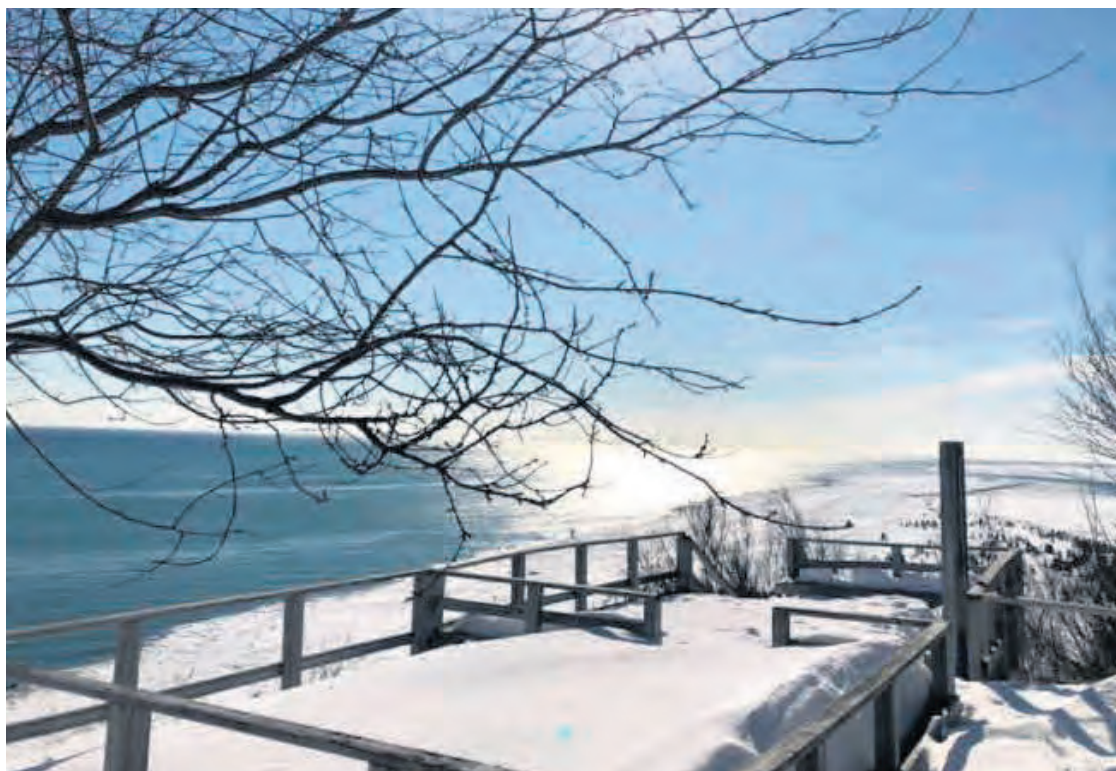
L'escalier qui mène au belvédère de la Pointe-des-Fortin nécessite des travaux majeurs. Une expertise technique sera fournie à la Municipalité dans le cadre du déploiement de services offerts par la Fédération québécoise des municipalités. Photo courtoisie
