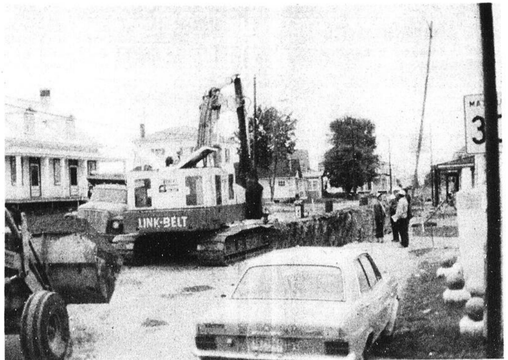
La route 347 est à l'envers et le village de St-Norbert aussi. On peut le constater, les hommes s'affairent à l'installation du réseau d'égout. La très vieille chanson "Sur la route de Berthier" est encore et toujours d'actualité. A partir de cette année espérons qu'elle retournera à notre folklore seulement!
