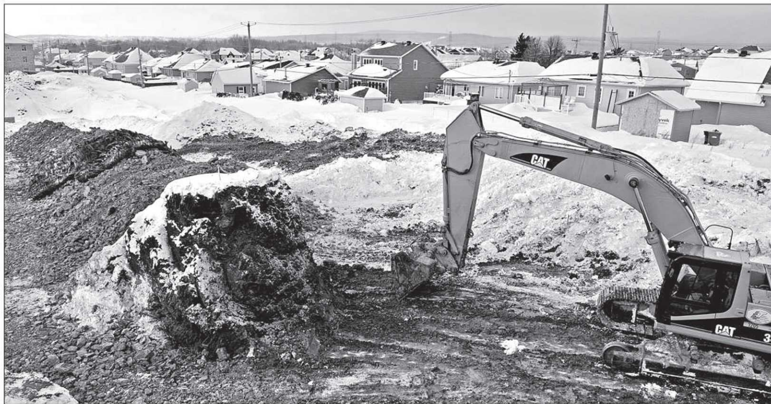
Les activités de dynamitage près des résidences touchées pourraient être à l'origine des infiltrations de monoxyde de carbone. — PHOTO LE SOLEIL, PATRICE LAROCHE
