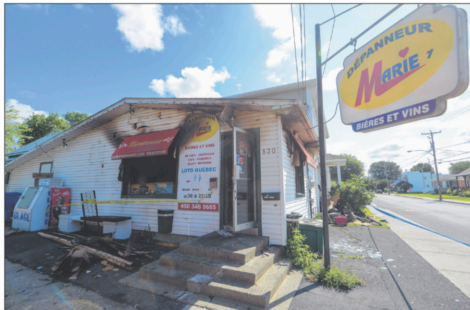
Une trentaine de pompiers ont combattu cet incendie survenu au 890, rue Honoré-Mercier.
