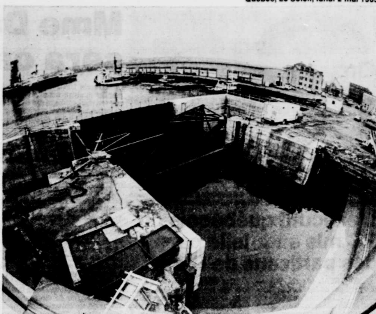
Les portes de la nouvelle écluse du bassin Louise sont en place. Il reste à fixer les joints étanches.
