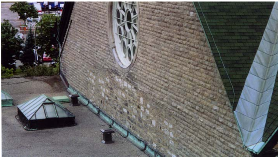
101. Montréal. Sainte-Brigide. Sur le mur pignon, on reconnaît les traces du comble du premier presbytère (photo Bérengère Gagné, architecte)
