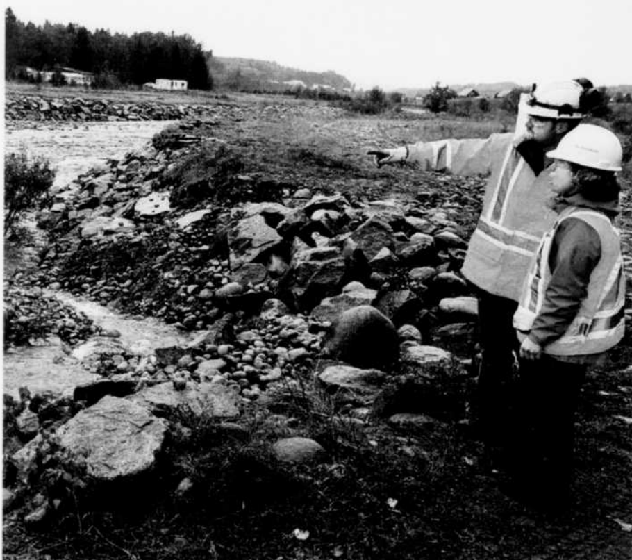
Suzanne Dupuis, conseillère principale en Environnement pour les opérations de Métal primaire en Amérique du Nord et Pierre-Luc Aubut, conseiller en environnement et surveillant pour le chantier constatent les améliorations apportées à la Rivière-à-Mars.
