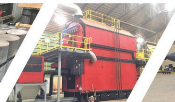
Chaudière à Bio-Masse pour chauffer des bâtisses (serres à légumes)
