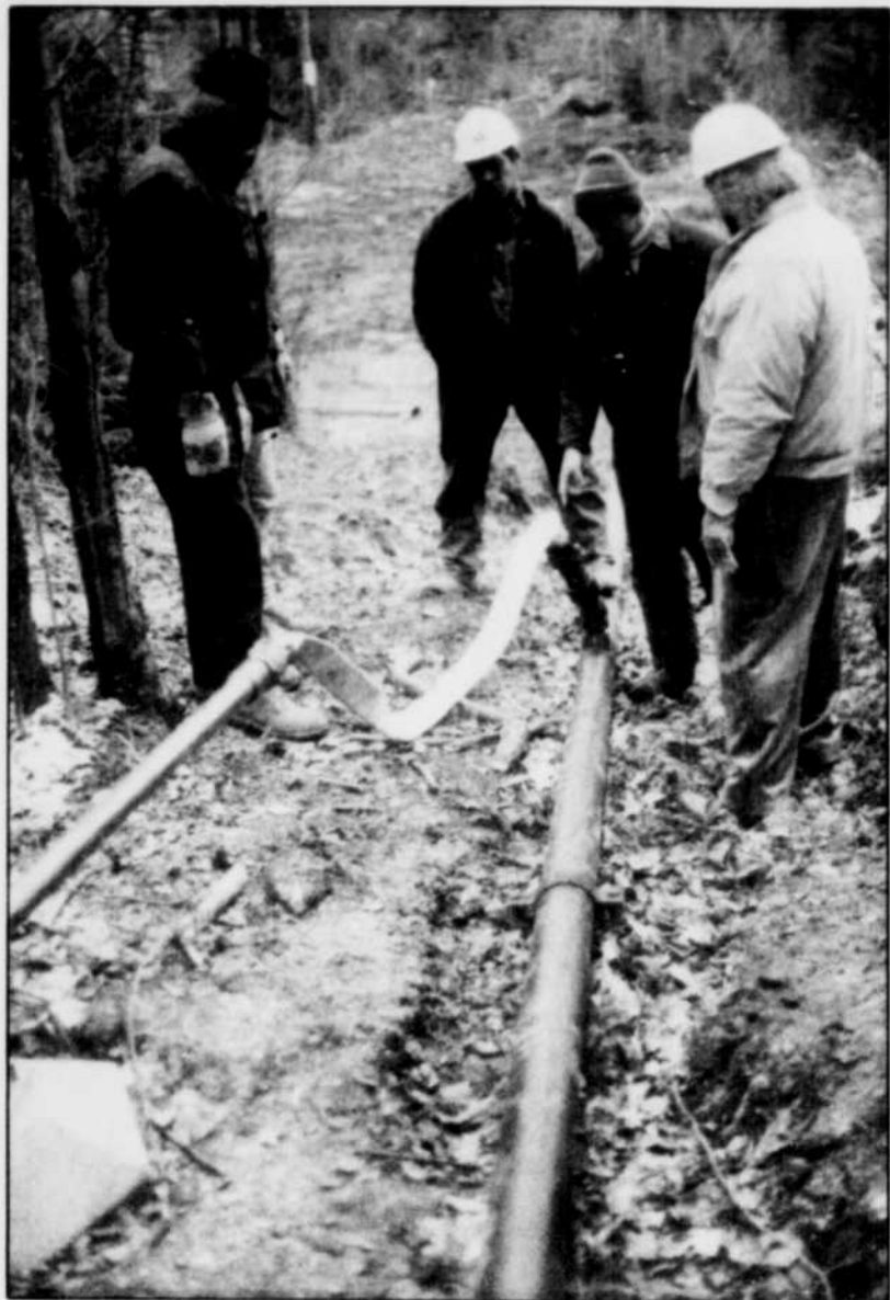
Les raccordements ont tenu bon lors des récents tests effectués par la compagnie Ganotec inc.
