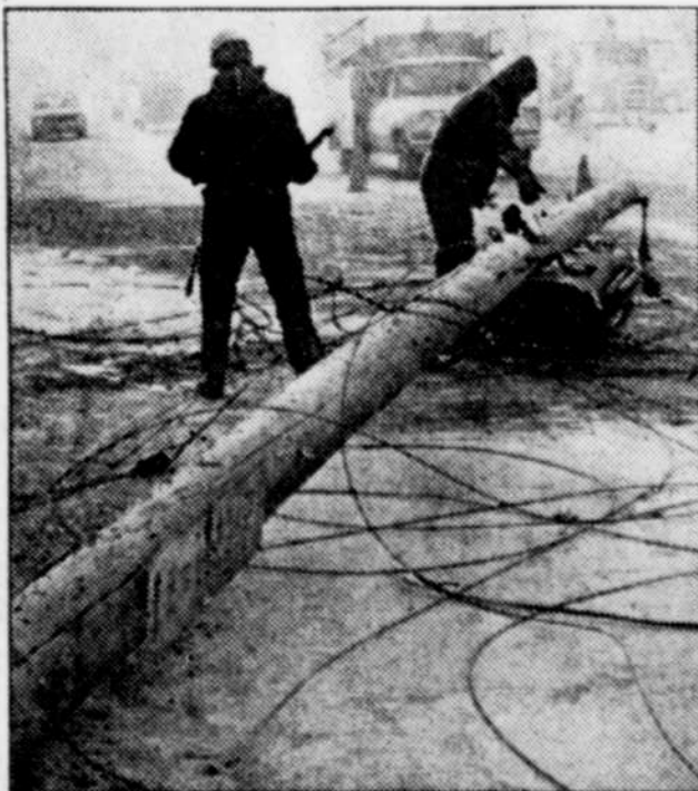
Dans 4 pour 100 des cas, les pannes d'électricité à Hydro-Québec sont causées par des poteaux cassés.
