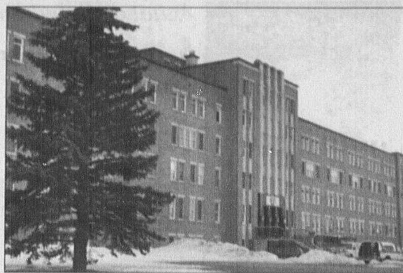
ÉDIFICE - La bâtisse du Claire-Fontaine ne répond plus aux besoins du Centre de réadaptation en déficience intellectuelle. Le piètre état de l'édifice construit en 1958 pourrait avoir des conséquences néfastes sur la santé et le bien-être des membres du personnel.
