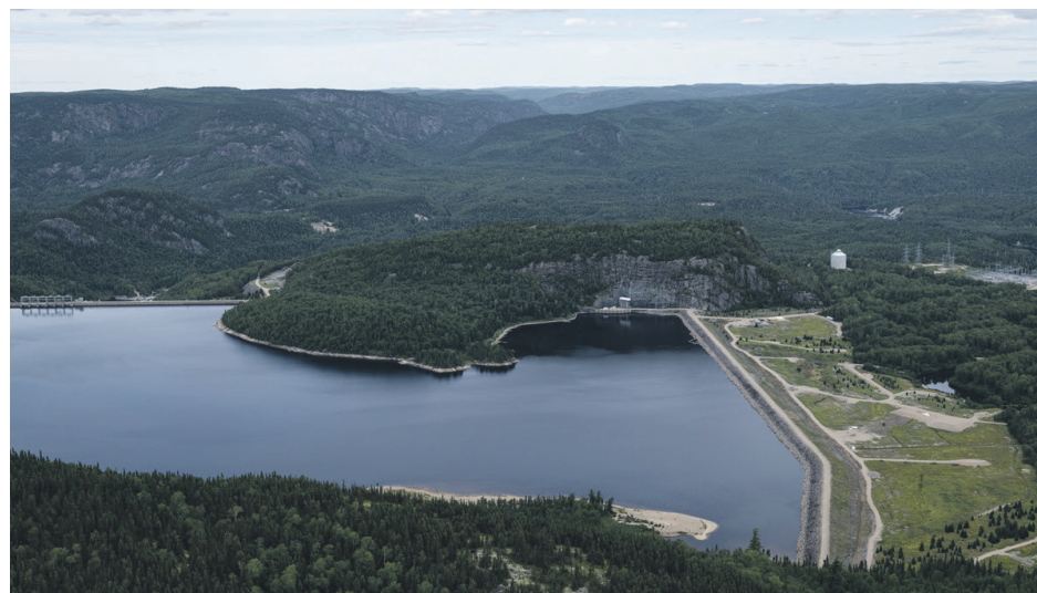
Les travaux de réhabilitation des aménagements à Bersimis-2 se poursuivent à raison de 7 jours sur 7, de 7 h à 17 h 30. Photo Hydro-Québec
