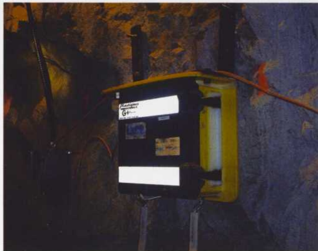
Unité d'accès Wireless LAN installée sous terre.
