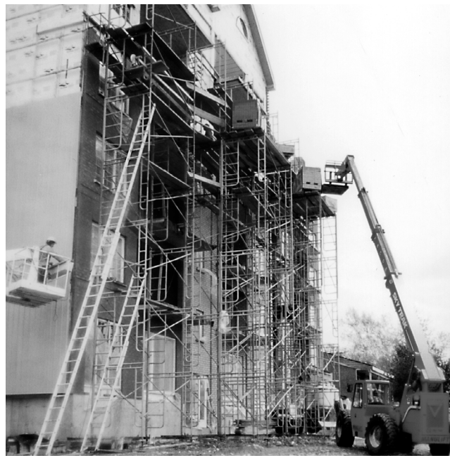
Échafaudage sur cadres métalliques ouverts
