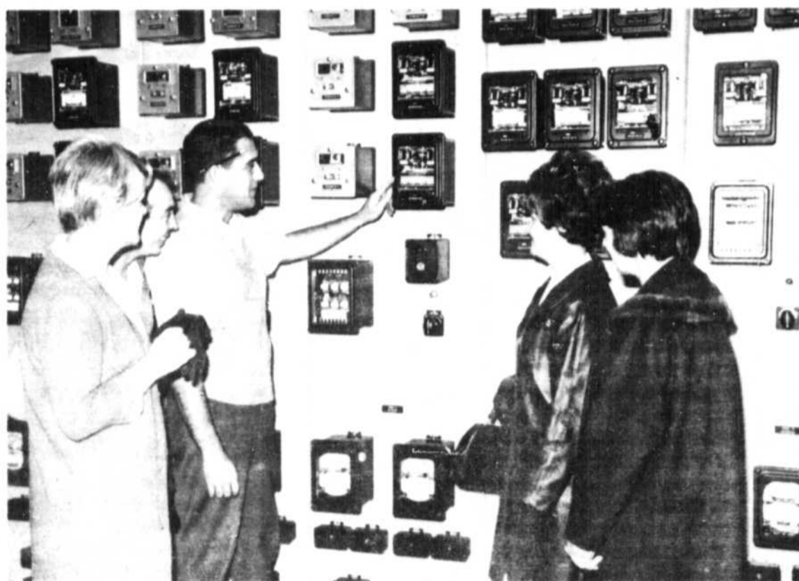
LA NOUVELLE SALLE DE CONTRÔLE — Les employés au contrôle sont fiers de recevoir les invités dans leur nouveau local complètement réaménagé. M. Georges Honcharuk, opérateur, explique la fonction d'un instrument, à Mme Sabin Westerberg, M. Jean-Marc Bouchard, aussi opérateur, et Mmes Honcharuk et Bouchard.
