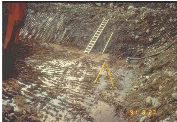
4. Fond d'excavation détrempé à assécher
