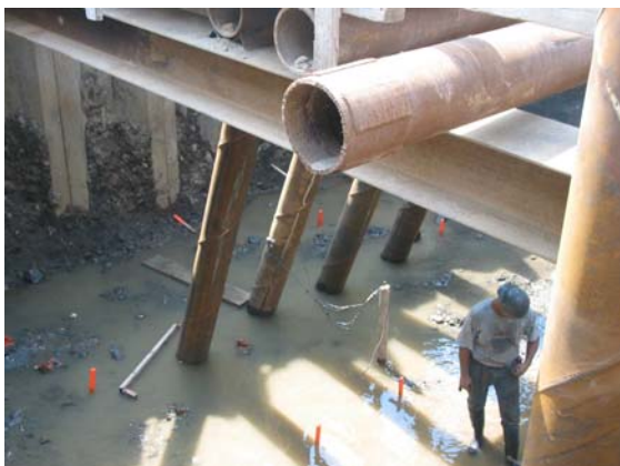
5. Fond d'excavation détrempé : nécessité d'un coussin de propreté
