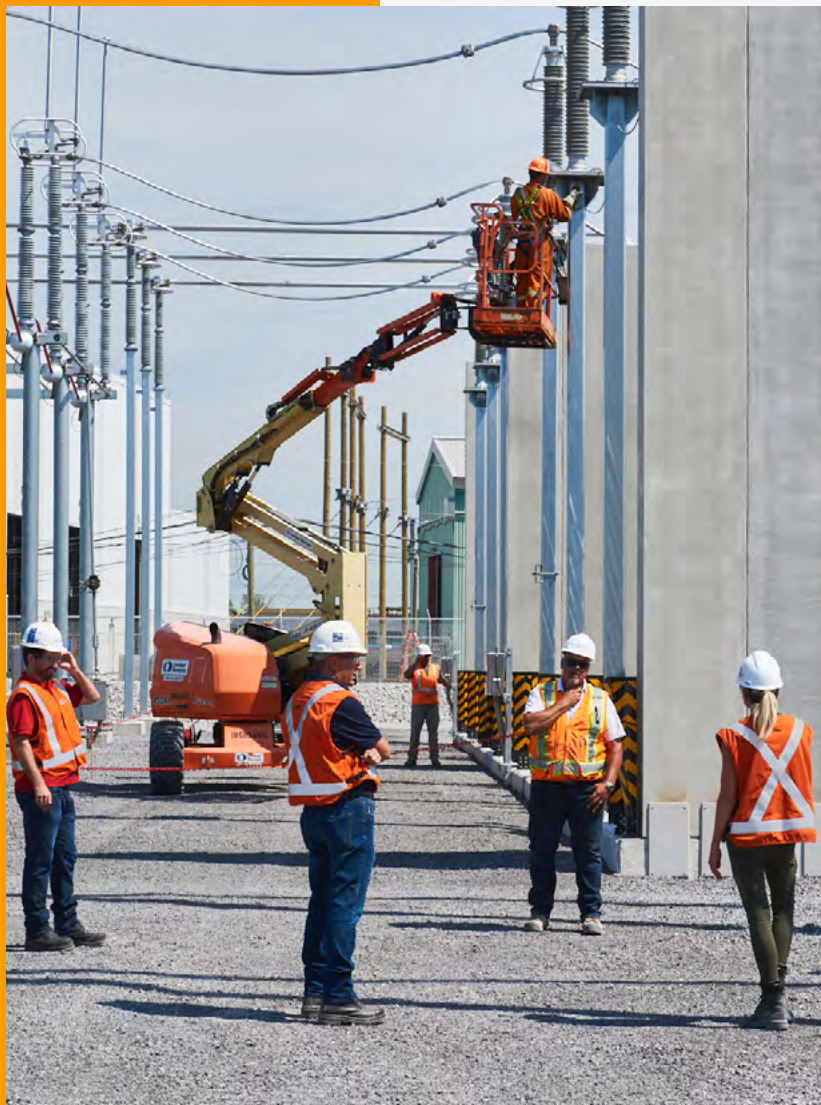
Mesures de prévention liées à la COVID-19 au chantier du poste des Patriotes à 315-25 kV à Saint-Eustache. Pierre-Alexandre Bernier-Dionne, chef - Travaux, Pascal Monette, chef - Projets, Yves Horth, conseiller - Sécurité et Annie Giguère, chef - Réalisation de projets de transport
