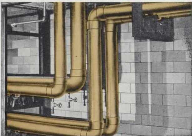
CI-DESSUS se voit la conduite principale d'eau de 8", la conduite de 6" pour les incendies et les deux conduites d'eau chaude de 6", toutes en tuyau de cuivre Type K. A remarquer que les tuyaux ne touchent pas au support d'acier. Ils reposent sur des bandes de cuivre soudées sur le support en forme de U.
