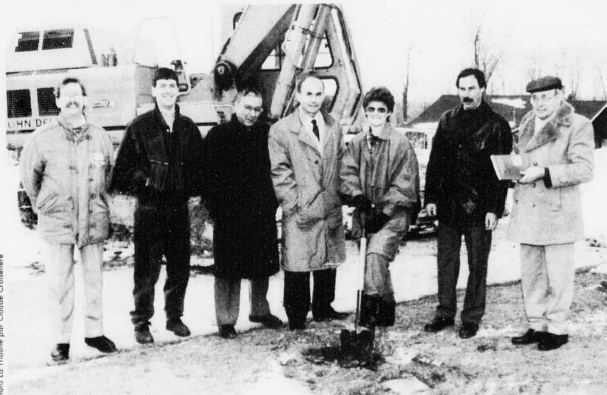
Colette Dion, la présidente du conseil d'administration, effectue la levée de la première pelletée de terre pour marquer le début des travaux de construction d'une nouvelle caisse populaire à St-Sébastien. La cérémonie s'est déroulée en présence de Clément Lambert (le directeur-général de la caisse), de Sylvain Dion de la compagnie de construction Fa-Syl Inc, de l'architecte André Gaouette, du maire Gyslain Giroux, de Fabien Nadeau de la firme Fa-Syl ainsi que le curé Louis-Philippe Gilbert.
