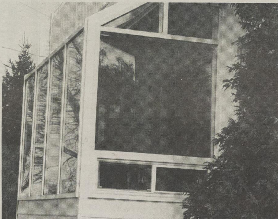
CONDENSATION - A la fin de l'automne et à l'approche de l'hiver il est normal de voir apparaître de la condensation dans les fenêtres.
