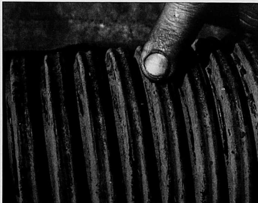
Un exemple rencontré fréquemment : les drains colmatés par l'oxyde de fer.
