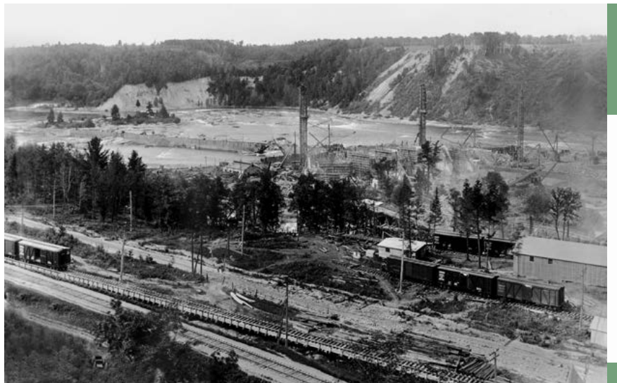
Cette photographie, prise au printemps 1923, montre la construction de l'évacuateur de crues sur le lit de la rivière. Les trois tours sont associées au bétonnage. La voie ferrée du Canadien Pacifique est visible à l'avant-plan. Au plus fort des travaux, le chantier pouvait recevoir jusqu'à 30 wagons de marchandise par jour.
