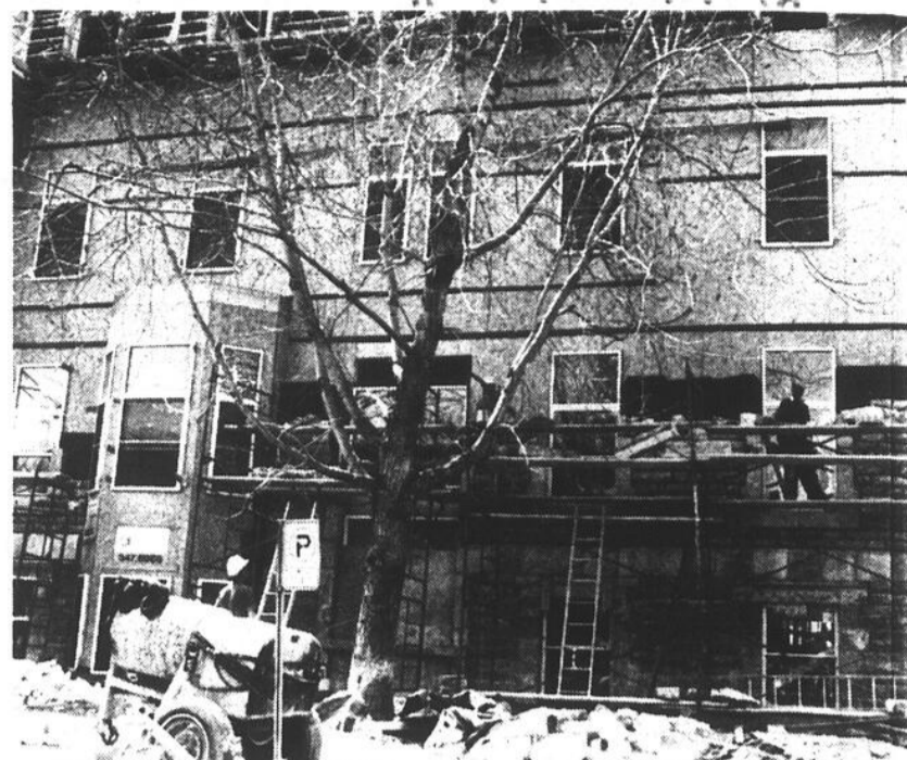
S'il manque des pierres pour la reconstruction de la façade, le maçon Guy Kelly ira s'en procurer sur les ruines du collège Saint-Maurice de Saint-Hyacinthe, incendié le 7 avril dernier. (photo jacques PAUL)
