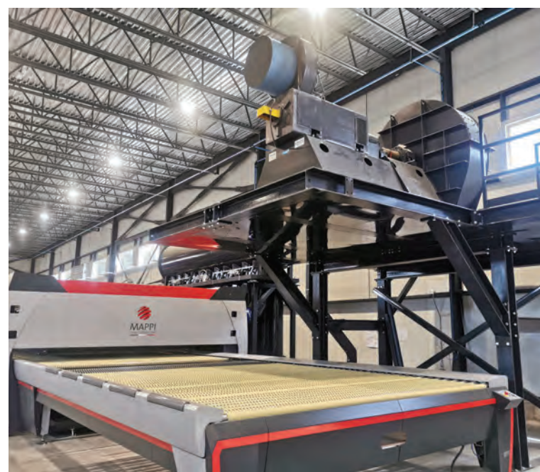
Voici le nouveau four à trempage du verre, un équipement à la fine pointe de la technologie.
