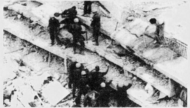
DEGATS — Au lendemain du séisme qui a frappé la Grèce, les secouristes constatent les importants dégâts causés à tout le secteur.
