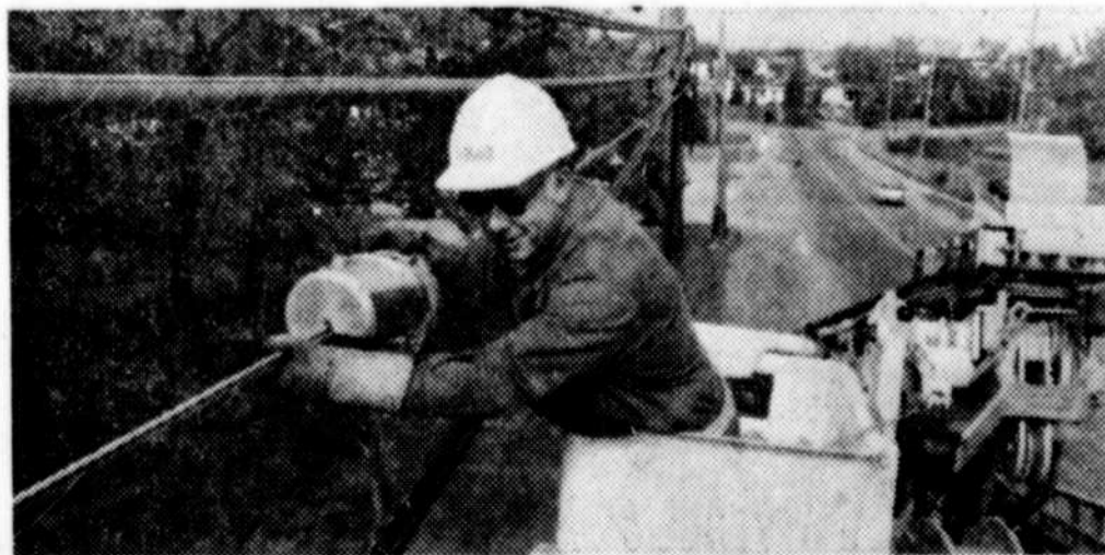
Plusieurs employés de la région ont contribué à l'amélioration du service téléphonique de Bell Canada. Un monteur est à vérifier une épissure d'un gros câble.
