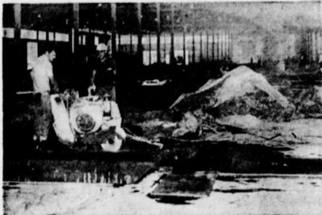
Vue de l'intérieur de la nouvelle usine de la Société de Montage Peugeot-Renault. Les ouvriers, au nombre de 75 présentement, sont en train de terminer la pose du plancher de béton. Dès que celui-ci sera terminé, on commencera à installer la machinerie, ce qui devrait se faire dès la semaine prochaine.
