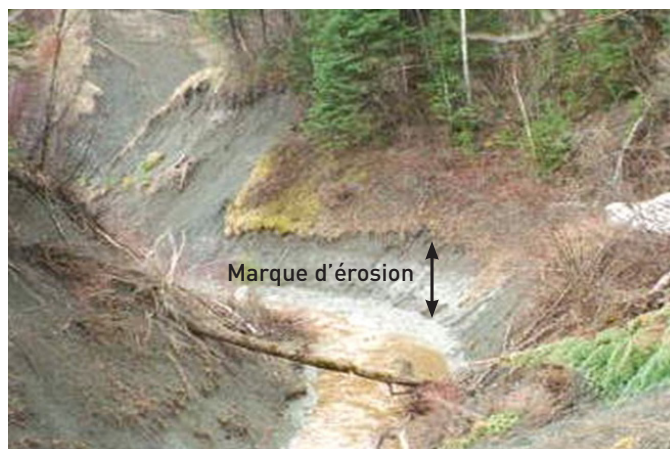
Figure 4 | Marque d'érosion à la base d'un talus
