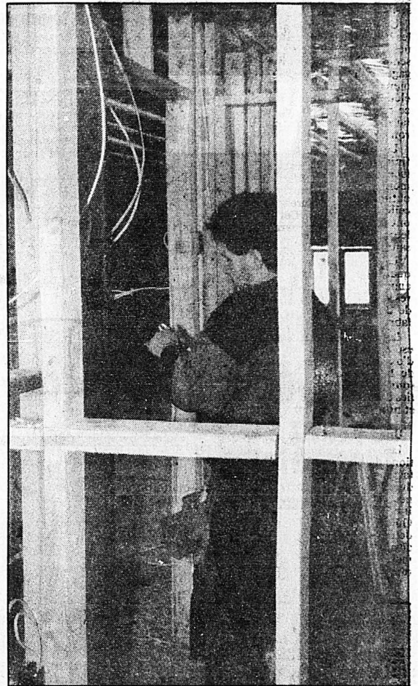
Stéphane Valiquette, employé de l'Entreprise d'électricité Laurent Sorel inc., procède à la pose d'un boîte d'interrupteur.
