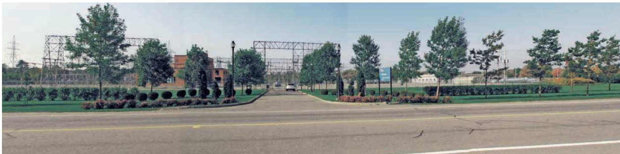
Figure 7 | L'intégration urbaine du poste de Trois-Rivières.
